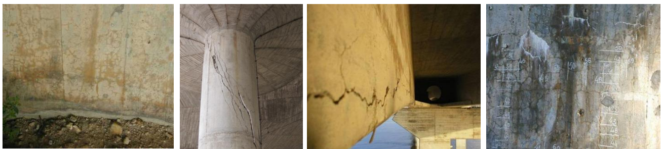
Figura 14: Fissuras de diferente origem
