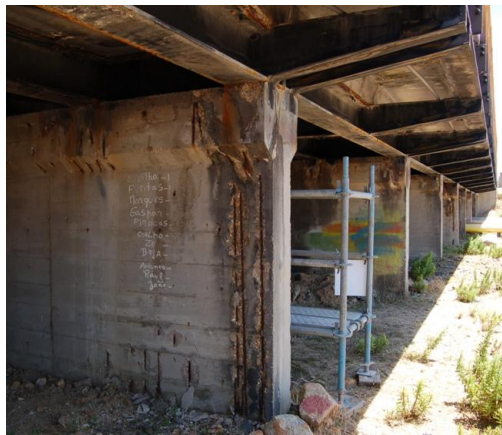
Figura 1: Corrosão do aço induzida por cloretos
